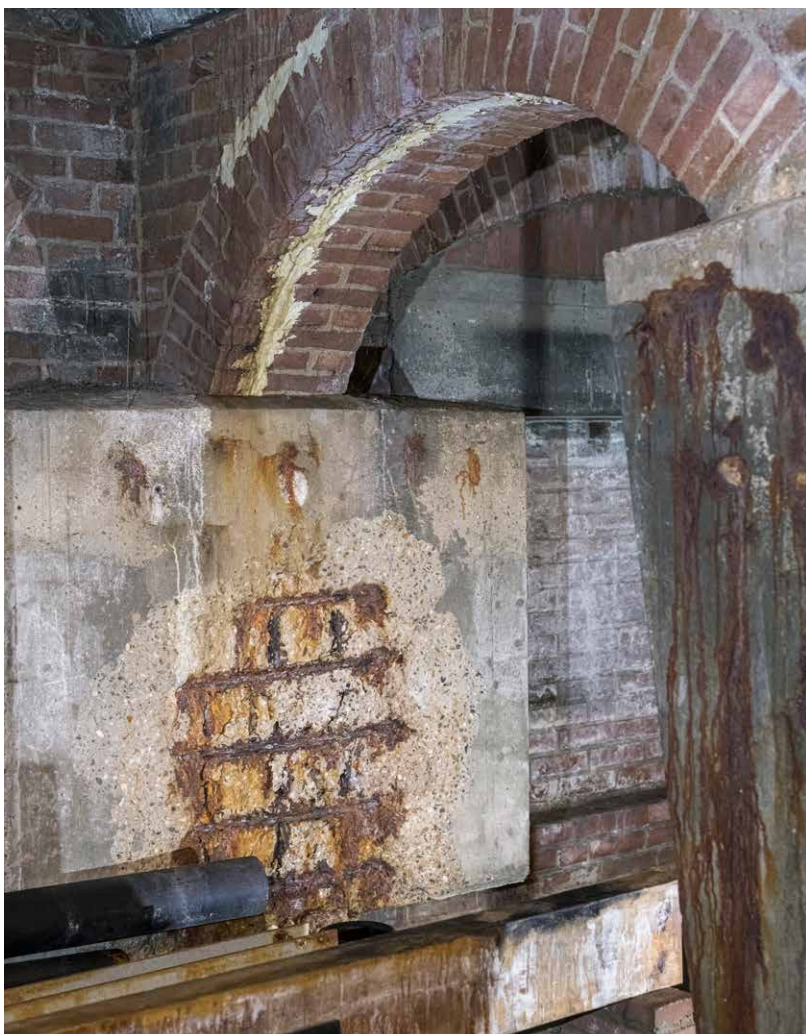
Door betonrot aangetast beton van het aquarium
