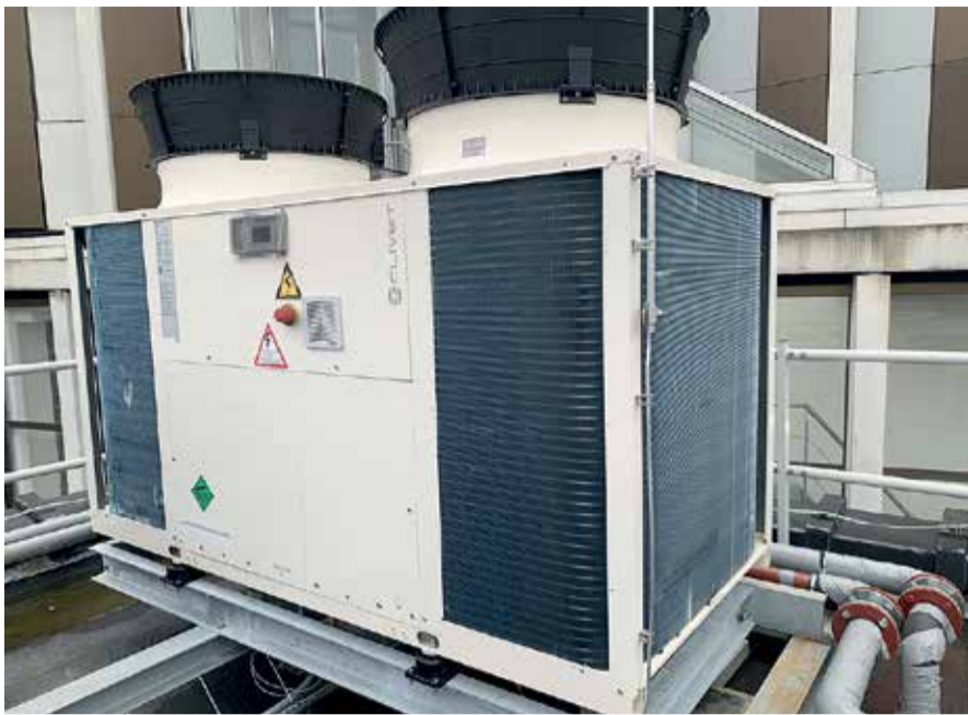
Op het dak is de 57 kW-warmtepomp geplaatst. Die is zo ver mogelijk naar achteren op het dak gezet, zodat vanaf de straat deze en de luchtbehandelingskasten niet te zien zijn.
