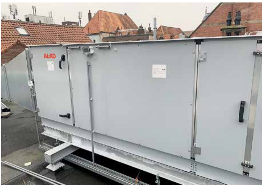
Op het dak van de hostel is een van de in totaal 3 luchtbehandelingskasten geplaatst, elk met een debiet van 3350 m 3 /h.
