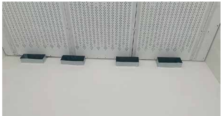
De voormalige schoollokalen, die nu tot tentoonstellingsruimten zijn omgebouwd, worden van frisse lucht voorzien via ventilatie bovenin in de ruimten.
