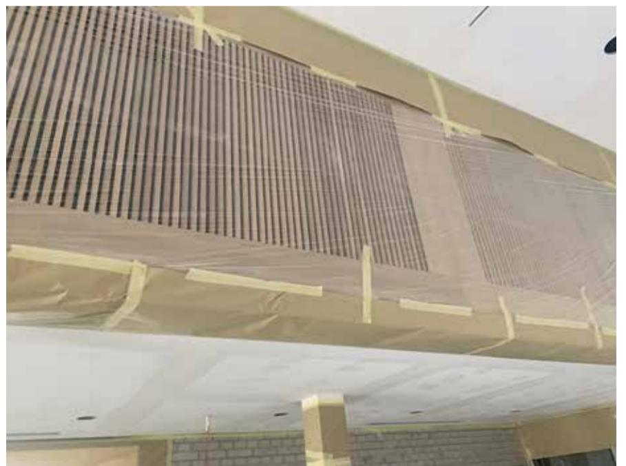
Omdat er weinig ruimte was voor een technische ruimte voor het nieuwe en het bestaande gebouw, is de technische ruimte efficiënt ingepast tussen de tentoonstellingsruimte en het auditorium. Op de foto is deze te zien achter de nog ingepakte roosters.
