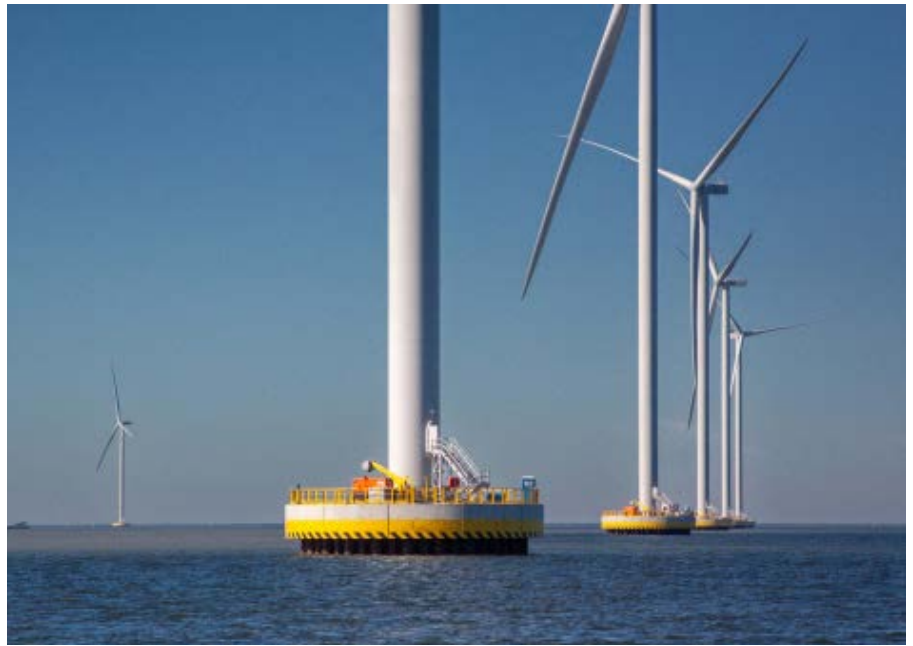
▲ Boven op de buispalen wordt de betonnen sokkel geplaatst waarop de turbine afgespannen kan worden. Afgebeeld is de gerealiseerde Cofferdam-constructie.
